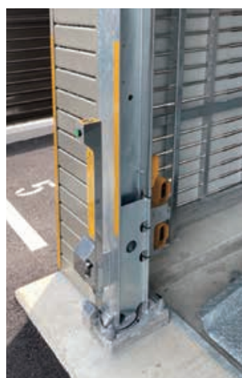
4 侵入検知センサ(ゲート外側)
